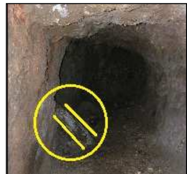
Détachement d'un bloc dans la galerie principale (photo Arnaud Poujade)
