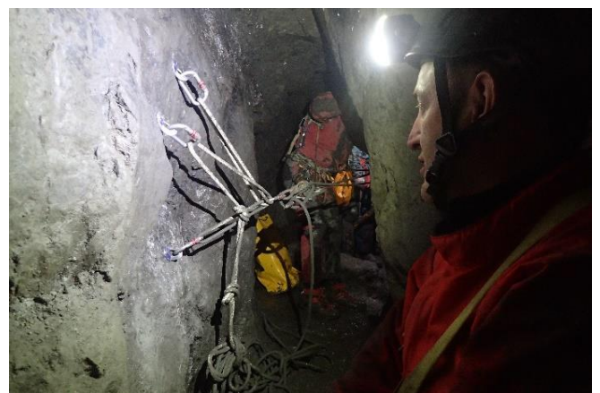
Vue de dessous d'un puits équipé avec un tube Multi D – Il reste quand même de temps en temps la possibilité de recourir à des techniques classiques.
